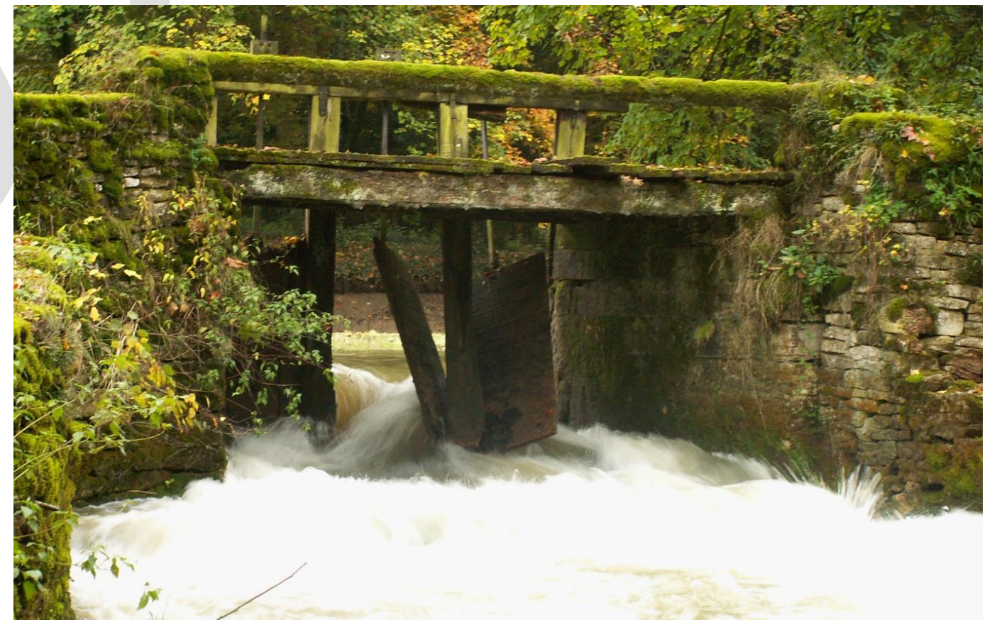
FIGURE 47: VANNES HORS D'USAGE SUR L'IGNON
